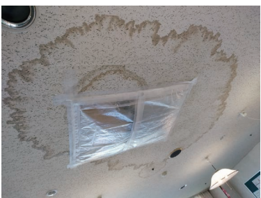
漏水した天井
